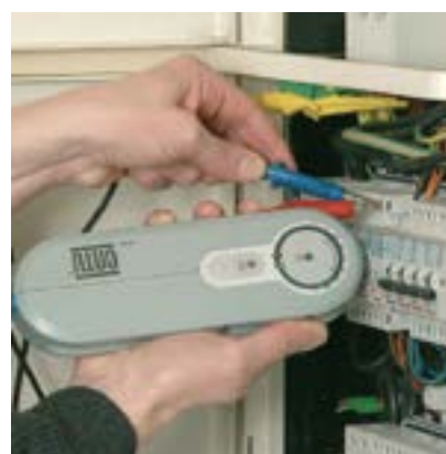
DT-500 sur installation consignée hors tension
